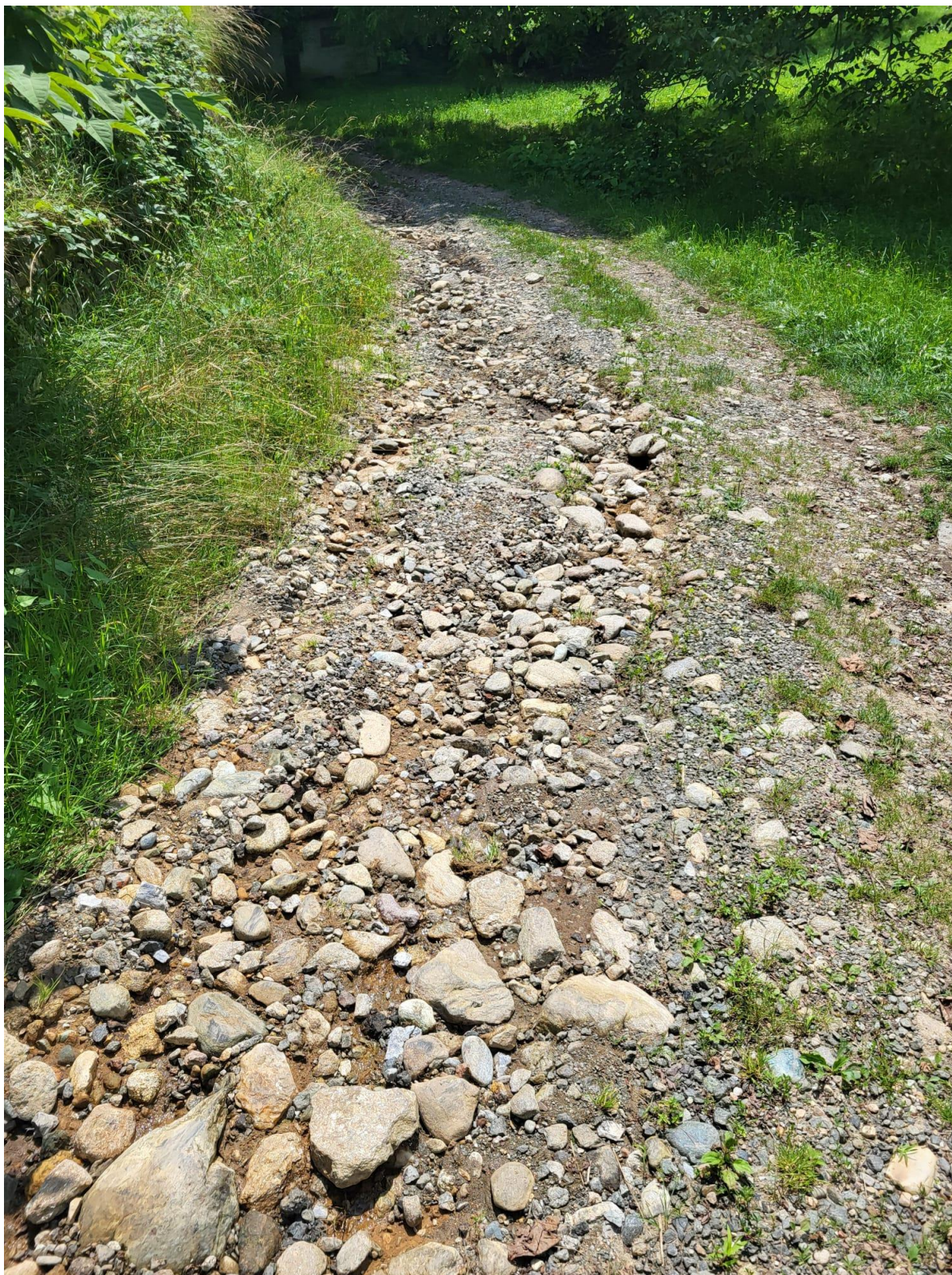
Foto 1 – Strada Comunale erosa e priva della parte “fine” a causa del ruscellamento incontrollato
